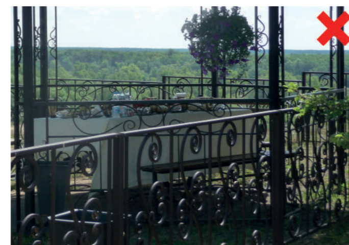
Металлические элементы, выполненные методом холодной деформации (гнутья). Такого типа элементы непригодны для общественных пространств.
