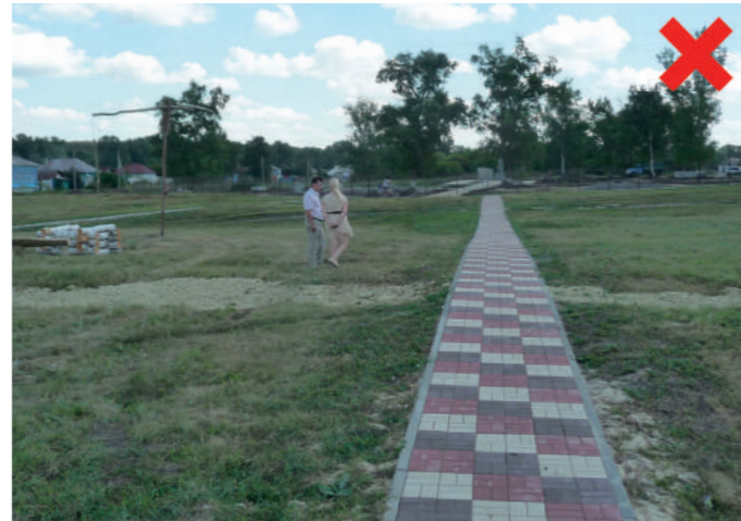
Применение цветной плитки подчеркивает недостатки качества плитки и работ по её укладке.
